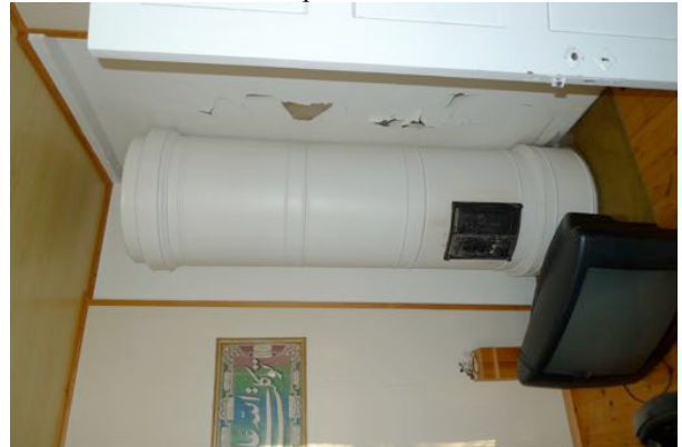
Ruokailutilan vanha uuni. Ei käyttökunnossa!
