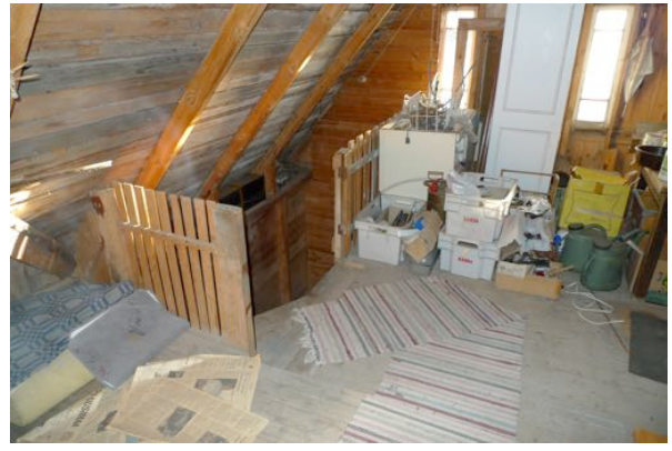
Huonokuntoiset portaat johtavat alakerran eteisestä ullakolle, jossa on jossain vaiheessa asuttu. Portaita vastapäätä olevassa lautaseinässä ei ole eristeitä.
