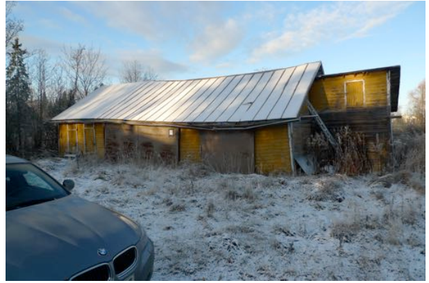
Alueella oleva toinen rakennus, entinen navetta ja vaja etelästä katsottuna. Rakennuksen kunto heikko, jopa sortumavaara olemassa. Pohjoispääty osittain avoin.
