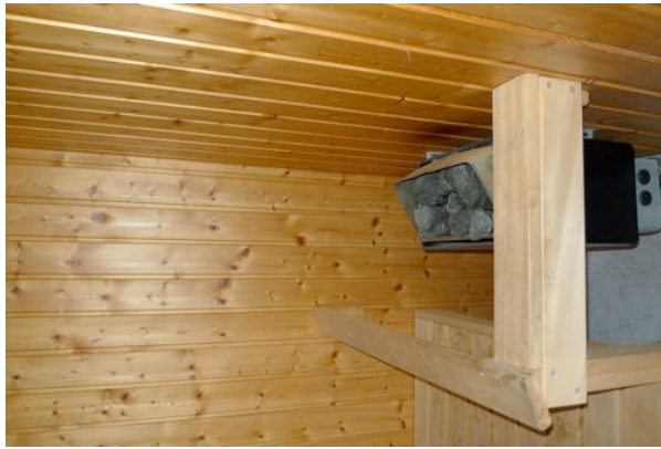
Saunan sähkökiuas. Sauna on rakennettu 1970-80-luvulla, joten se ei kuuluut alkueräiseen rakennukseen.
